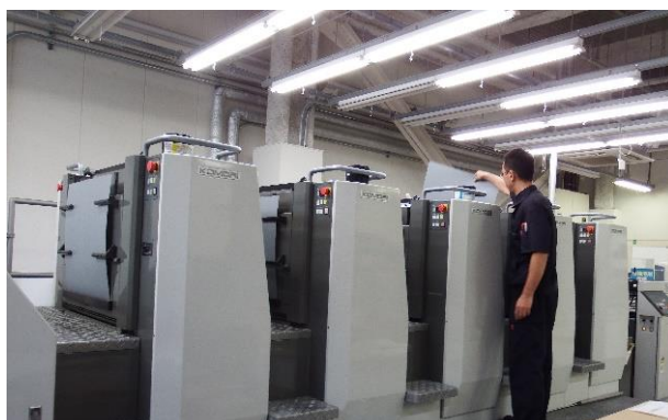
油性から H-UV へ転換し、完全無処理 CTP 化された
